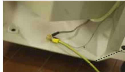
Cable de tierra
